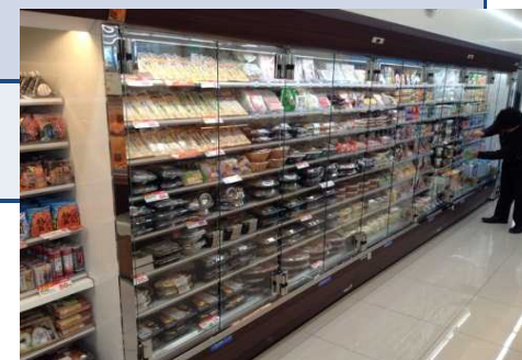
省エネ型自然冷媒機器のショーケースに扉を設置した例(ローソンパナソニック前店)
