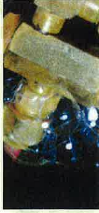
発泡液で漏えいを確認
