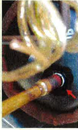
油濡れやしみて漏えいを確認
