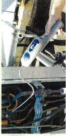
電子式漏えいガス検知器で漏えいを確認
