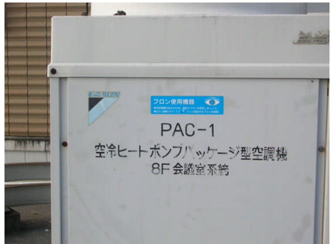
エアコン室外機
