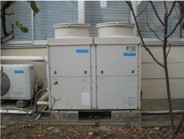
エアコン室外機
