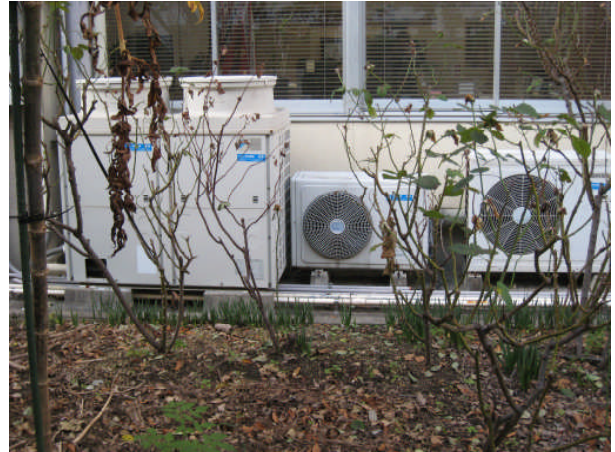
エアコン室外機
