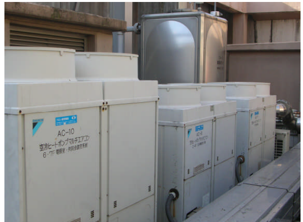
エアコン室外機
