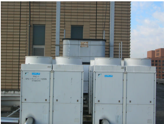
エアコン室外機
