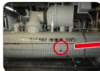
写真-A ターボ冷凍機
