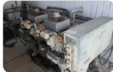
開放型冷凍機異常振動、異常運転音の確認
