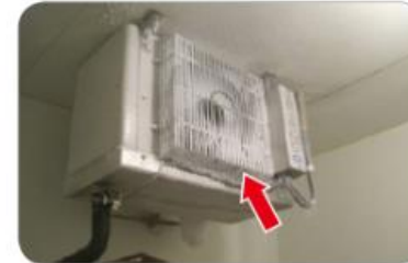
冷却器の内部霜付き異常
