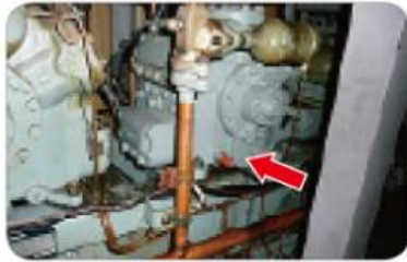
圧縮機周辺の油のにじみ状況
