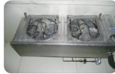
冷蔵庫内正常な冷却器外観
