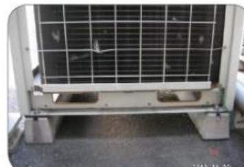
室外機のキズ
