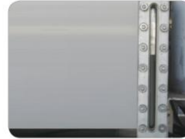
受液器液面計の液面位置
