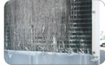
室外機の熱交換器表面の飛散水による腐食
