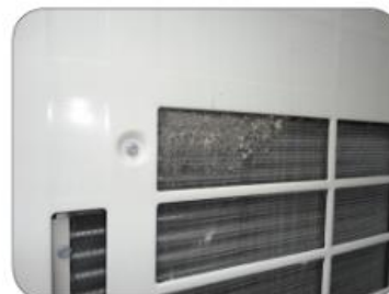
室外機に付着したゴミ
