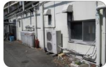
室外環境異常による配管の劣化
