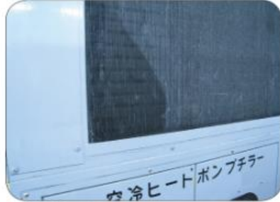
熱交換器の油のにじみ
