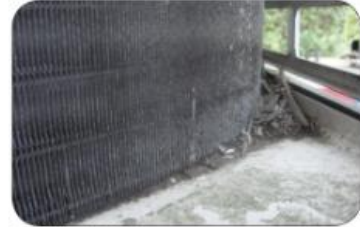
熱交換器下部の腐食
