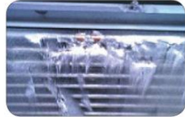
熱交換器表面の損傷
