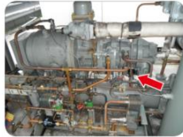
冷凍機本体配管部の油のにじみの確認
