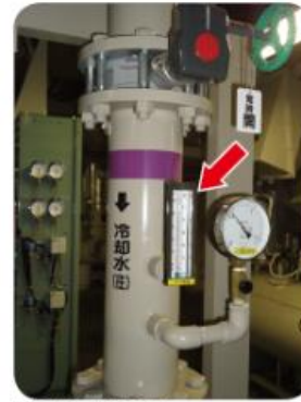
冷却水入口温度計確認
