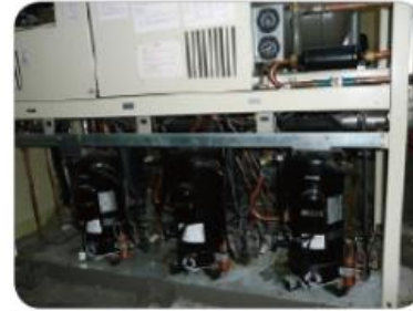
ユニット型冷凍機の異常振動確認
