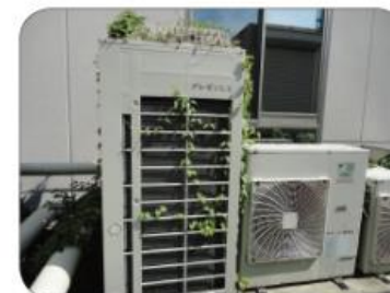
草で覆われた室外機
