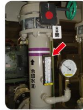
冷却水出口温度計確認
