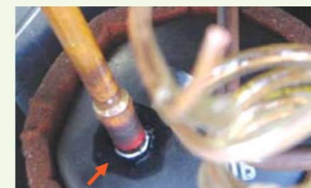
油漏れやしみて漏えいを確認
