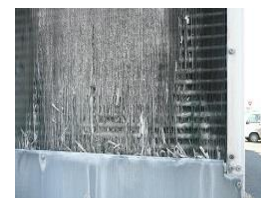
室外機の腐食
