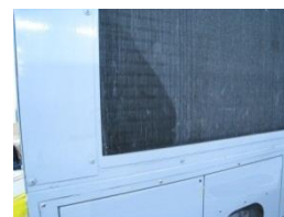
室外機の油にじみ
