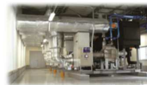
<中央方式冷凍冷蔵機器>
