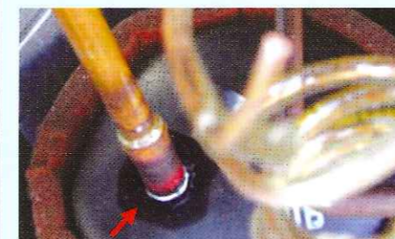
油漏れやしみて漏えいを確認
